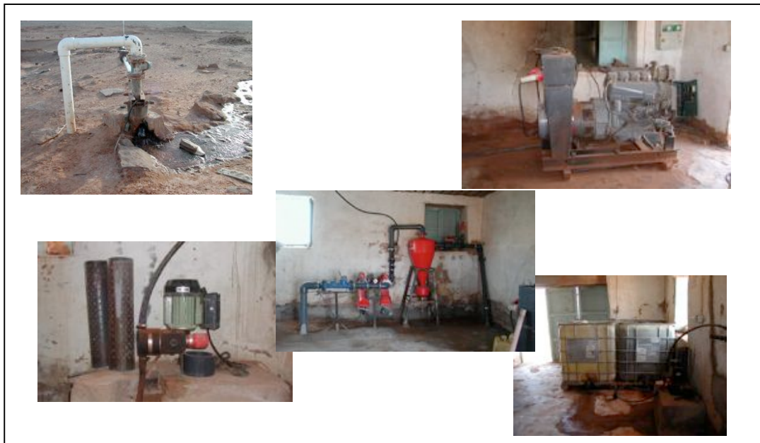
Figura 4. Sistema de bombeo fósil: bomba de gasoil con filtro para el Huerto de Extremadura en Dajla. Los filtros de arena que se aprecian en la foto central deben ser limpiados cada dos días.
